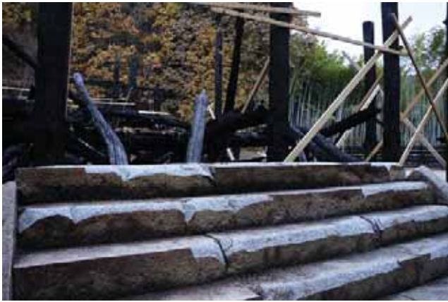
図9 本堂の階段の被災状況
