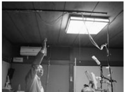
図8 カーテンレールによる配線固定(天井の高さを示すため、協同研究者が手を挙げている)
