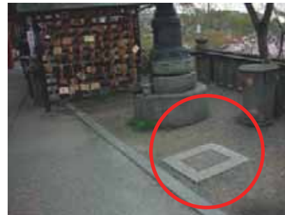
写真-2 地下式消火栓
